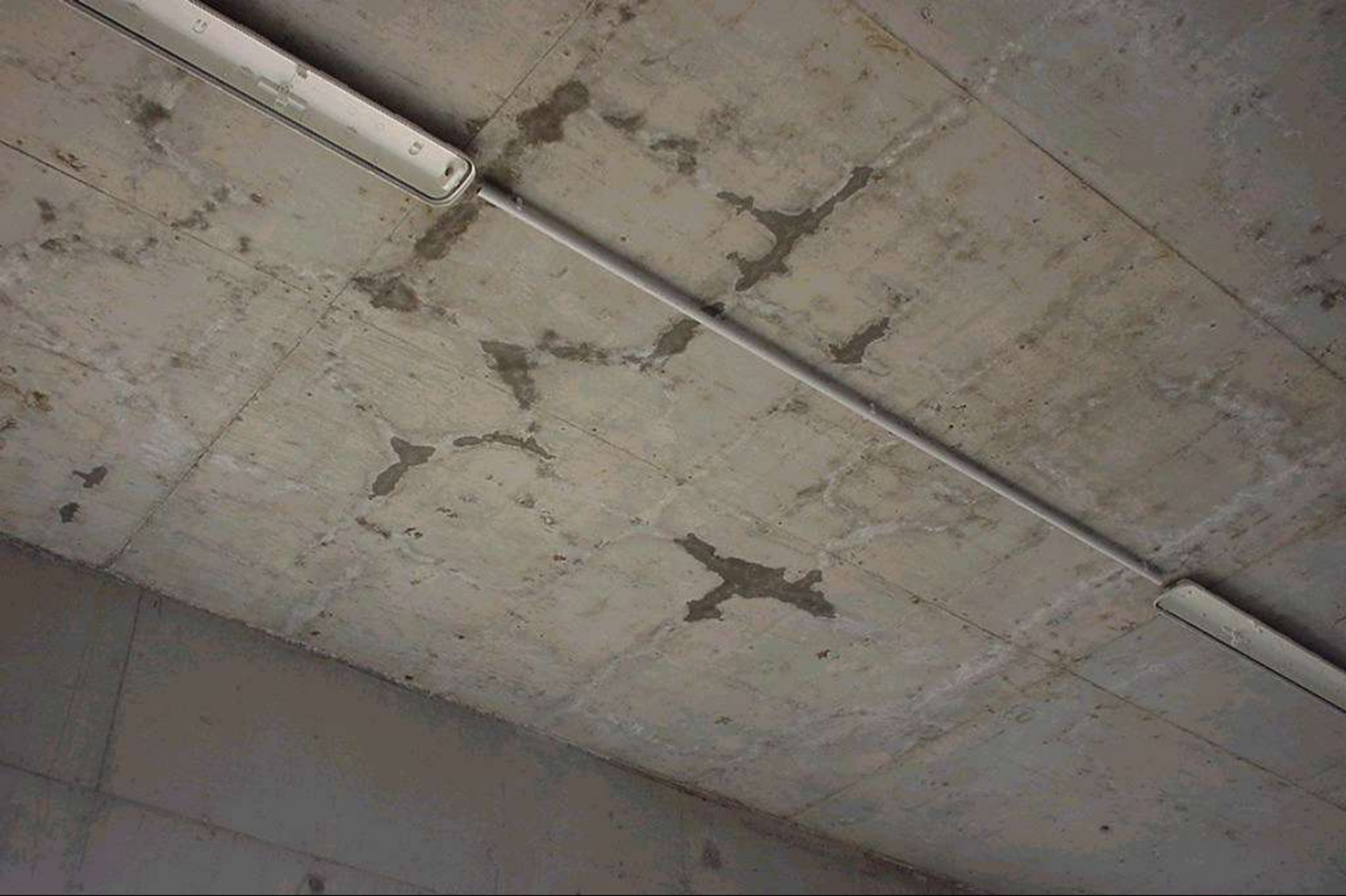
Fisuras por contracción plástica y secado prematuro de un hormigón colocado en tiempo caluroso
